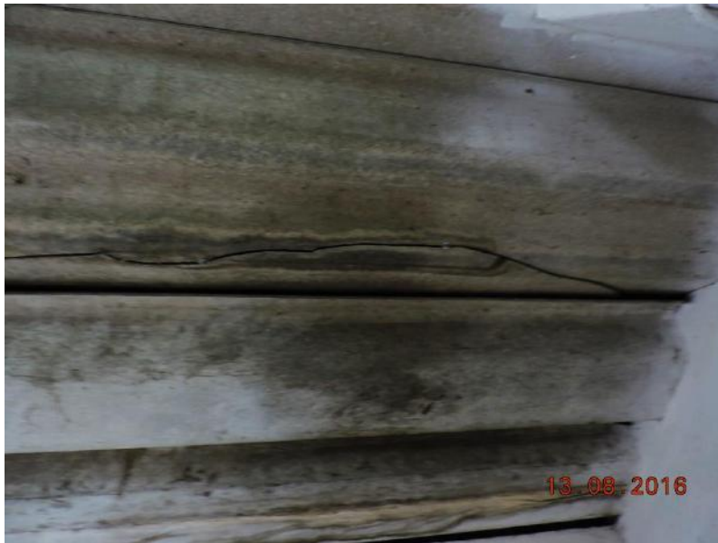
Falta de limpieza en azoteas
